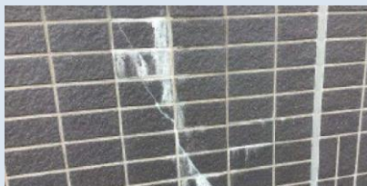
▲外壁タイル部ひび割れ・エフロレッセンス
